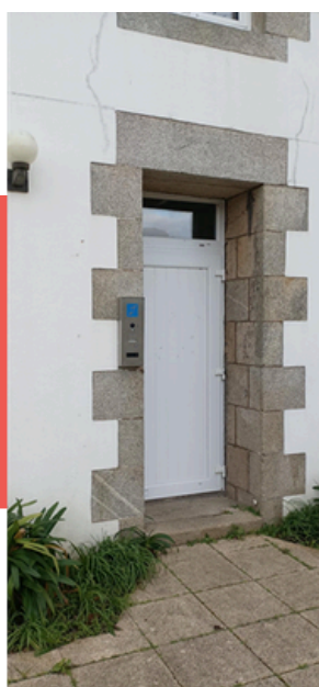
Pour une plus grande visibilité et une sécurité sans faille 3 visiophones ont été installés devant la Mairie, devant le portail de l'école et devant l'entrée de l'école.
